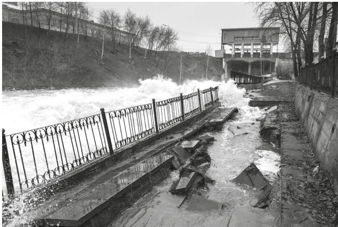
Обрушение и размыв набережной вешнячего прореза заводской плотины Старого Демидовского завода в весенний паводок. Нижний Тагил, 2017 г.
