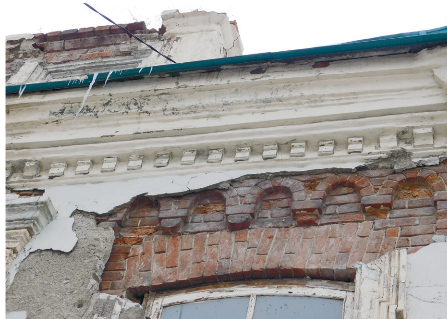
Ил. 1. Кирпичная кладка после обрушения штукатурного слоя. Дом Уткина
